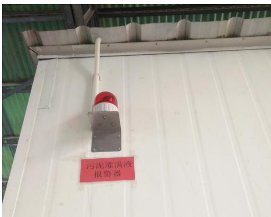
污泥罐满液报警器
