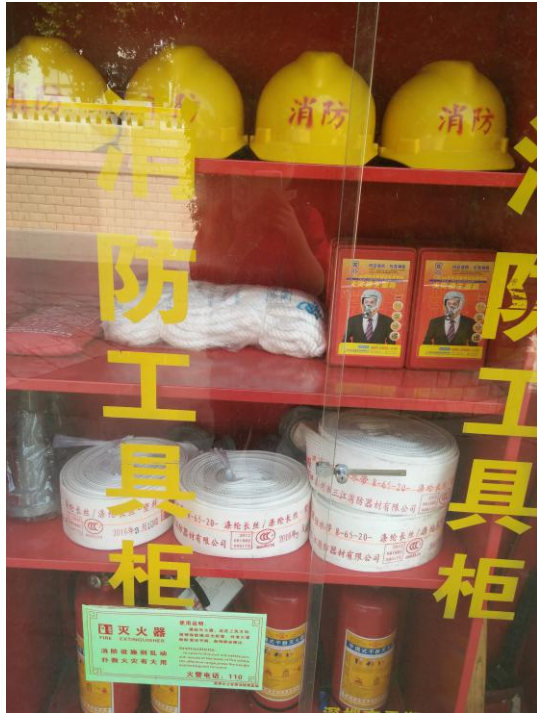
厂区中央消防工具柜
