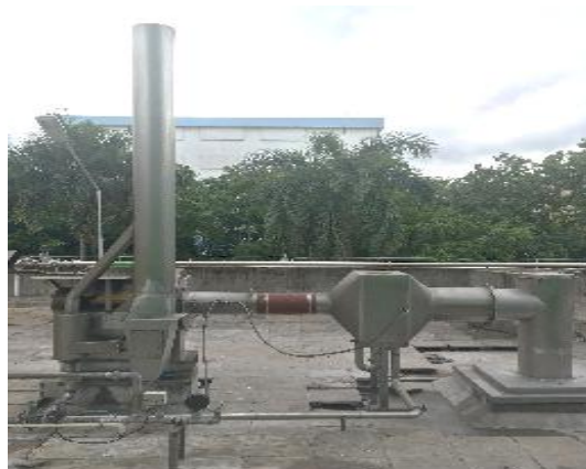
废气处理系统
