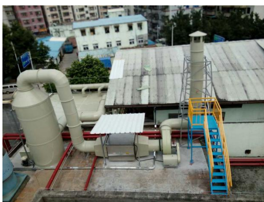
臭气处理系统
